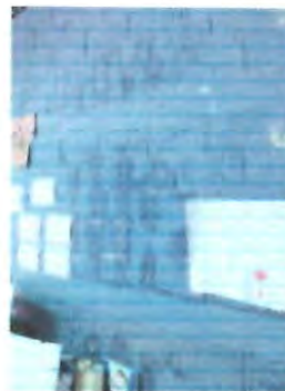
PINTURA EN PAREDES EXTERNA E INTERNAS, EN MAL ESTADO
